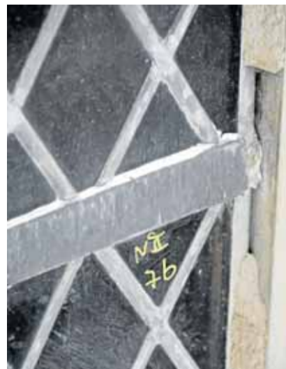
Der Putz bröckelt und macht die Schutzstreben instabil.
